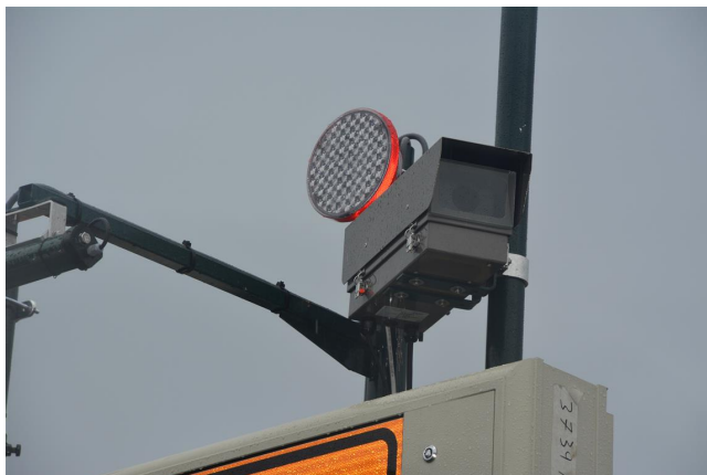
Luminansmåler utenfor tunnel. Foto: Tore Paulsen
