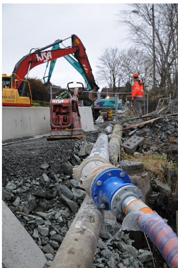
Figur 4: Rørledninger tilhørende veganlegg Foto: Anja Kristin Bakken
