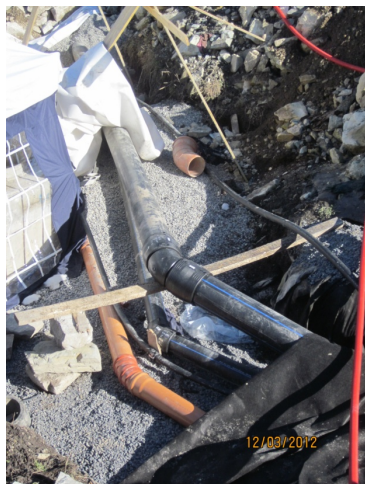
Figur 6: Rørledninger med bend. Foto Terje Rønneberg
