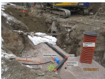
Figur 5: Rørledninger. Foto Terje Rønneberg
