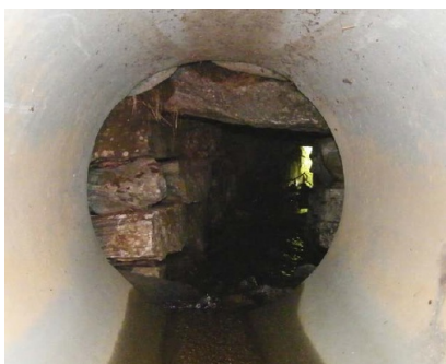
Figur 8: Stikkrenne som er forlenget
