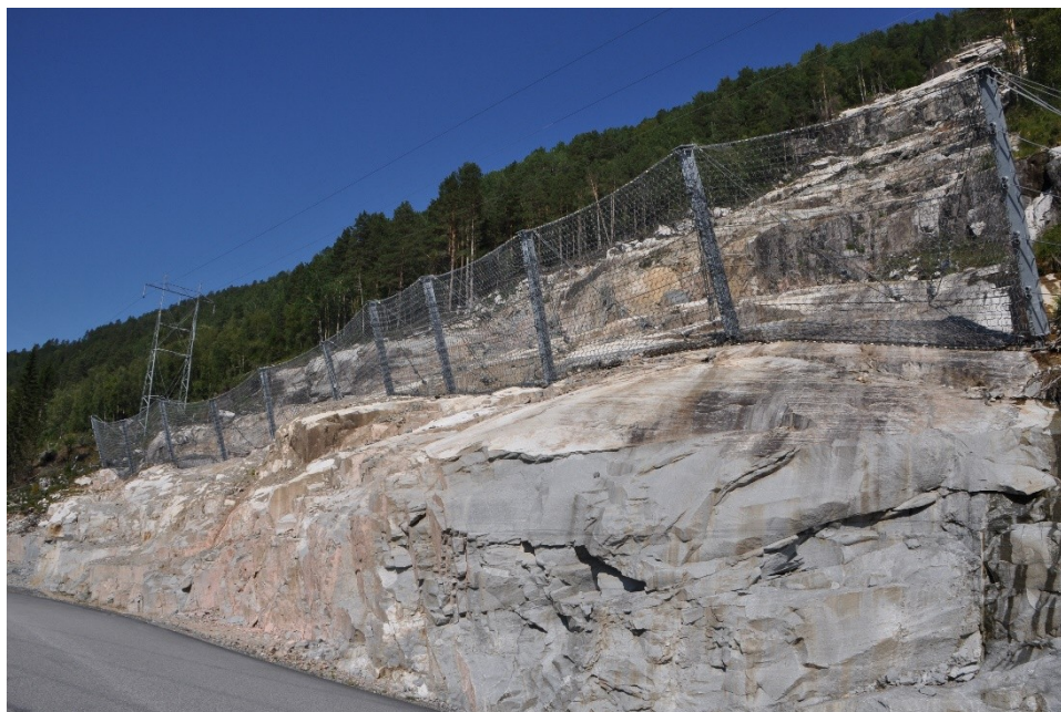
Figur 1 Fanggjerde (Foto: Halgeir Dahle / Statens vegvesen)
