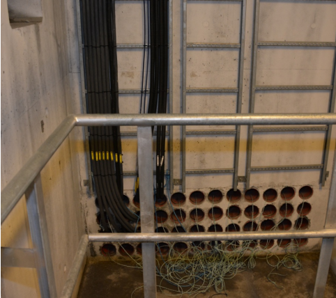
Trekkerør inn til hovedfordeling. Foto: Tore Paulsen
