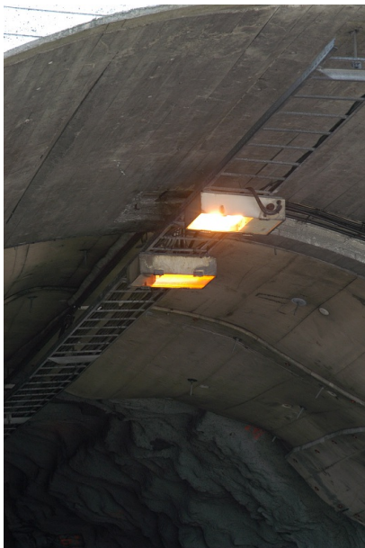
Lysarmaturer i Tunnel. Foto Kjell Wold
