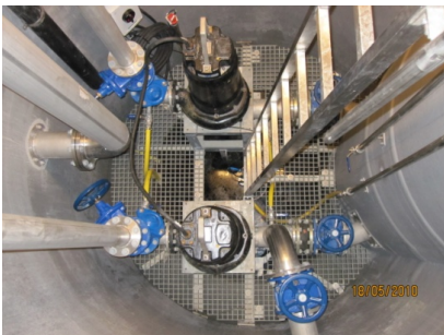
Pumpestasjon i kum. Foto: Terje Rønneberg
