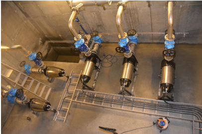
Pumpestasjon i Tunnel. Foto Tore Paulsen
