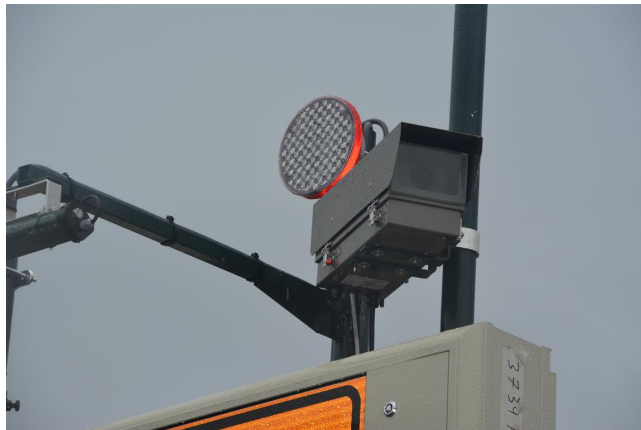
Luminansmåler utenfor tunnel. Foto: Tore Paulsen
