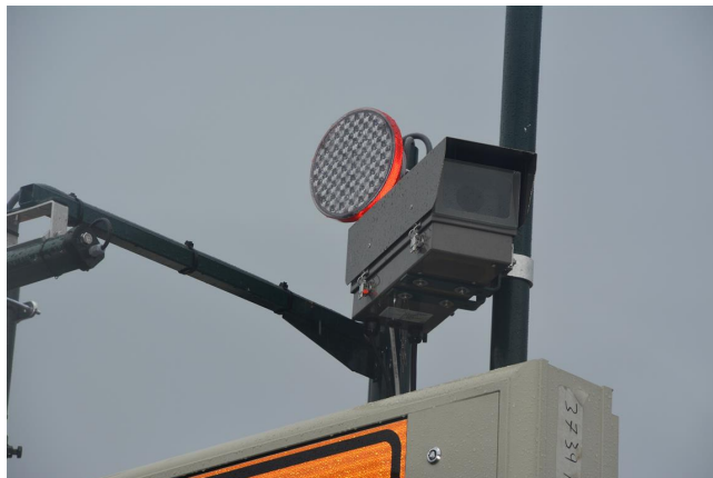
Luminansmåler utenfor tunnel. Foto: Tore Paulsen
