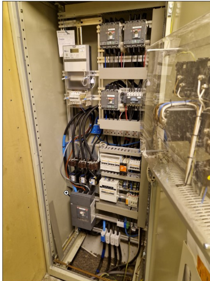
Figur 1 Elektrisk anlegg (Foto: Christian Noreng, Statens vegvesen)
