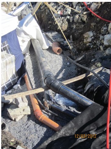
Figur 6: Rørledninger med bend. Foto Terje Rønneberg
