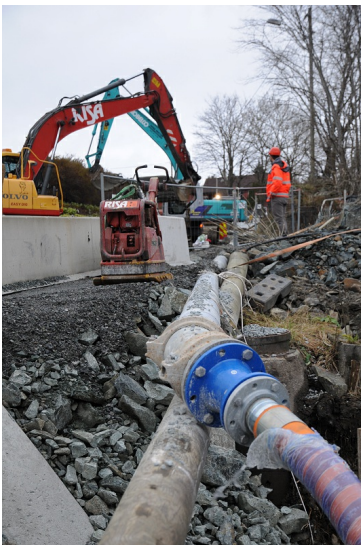
Figur 4: Rørledninger tilhørende veganlegg. Foto: Anja Kristin Bakken
