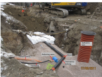
Figur 5: Rørledninger. Foto Terje Rønneberg
