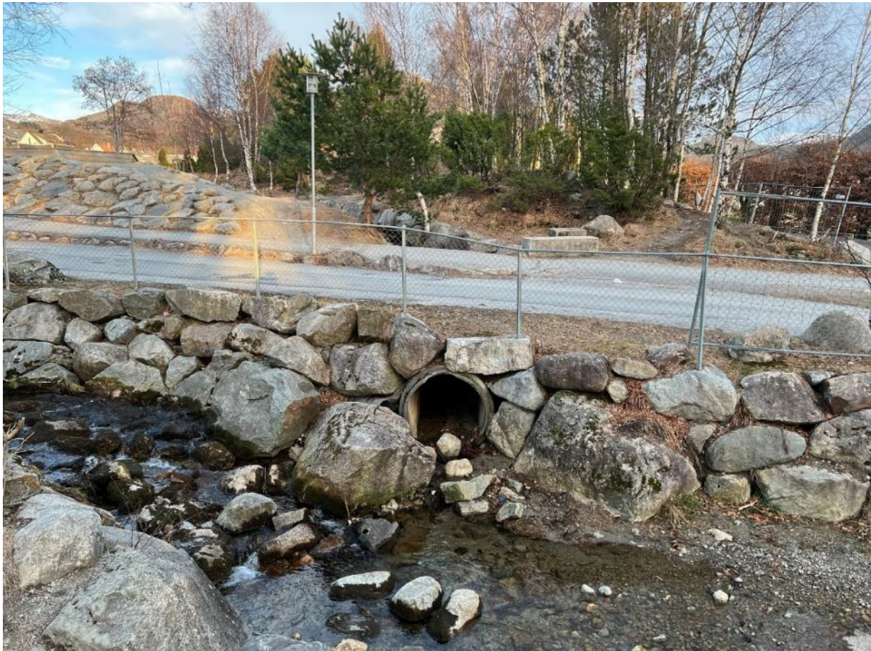
Figur 1: Kommunal stikkrenne. (Foto: Geir Magnus Tunland, Statens vegvesen)
