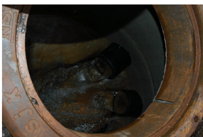
Kum i tunnel. Foto: Kjell Wold
