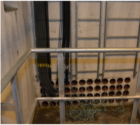
Trekkerør inn til hovedfordeling. Foto: Tore Paulsen
