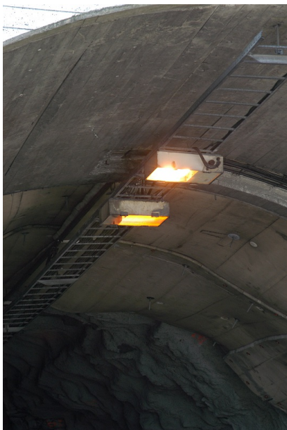
Lysarmaturer i Tunnel. Foto Kjell Wold
