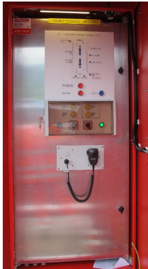
Figur 1 Nødstyreskap (Foto: Corinne Chiodini, Statens vegvesen)
