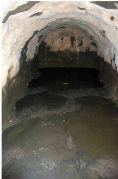
Pumpesump: Foto: Tore Paulsen
