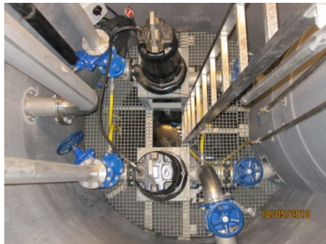
Pumpestasjon i kum. Foto: Terje Rønneberg
