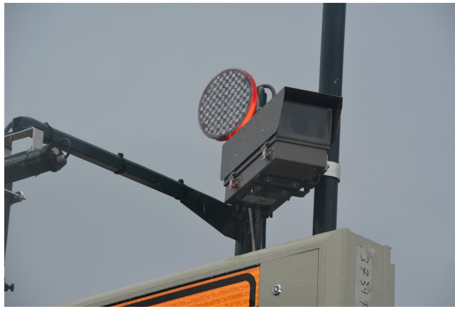
Luminansmåler utenfor tunnel. Foto: Tore Paulsen
