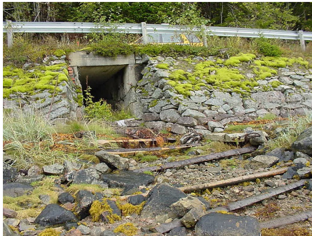
Stikkrenne. Foto: Per Gevik
