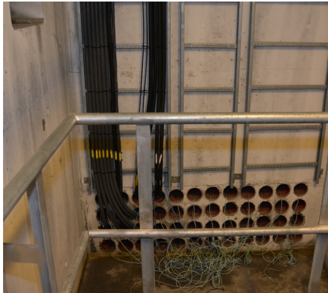
Trekkerør inn til hovedfordeling. Foto: Tore Paulsen
