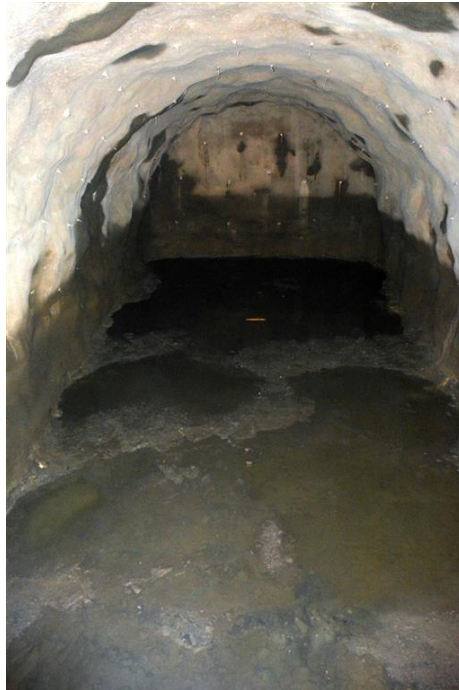
Pumpesump: Foto: Tore Paulsen
