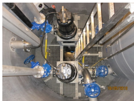
Pumpestasjon i kum. Foto: Terje Rønneberg
