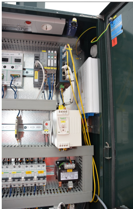
Måler plassert i fordelingsskap. Foto: Tore Paulsen
