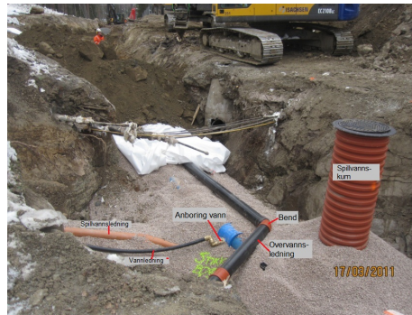
Rørledninger. Foto Terje Rønneberg
