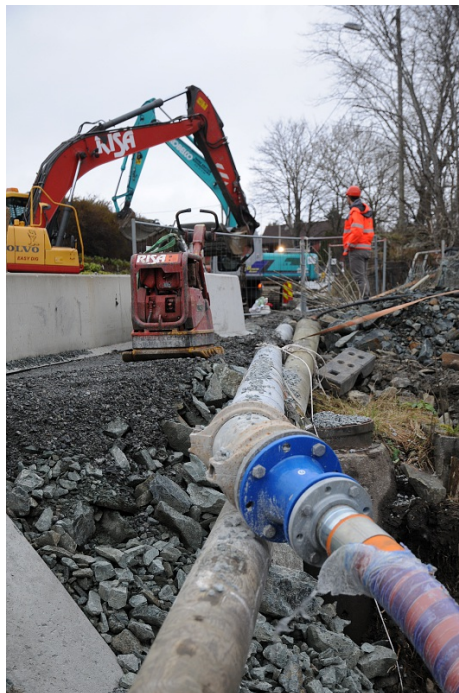
Rørledninger tilhørende veganlegg: Foto: Anja Kristin Bakken
