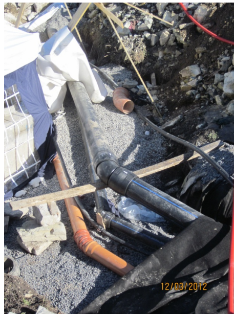
Rørledninger med bend. Foto Terje Rønneberg
