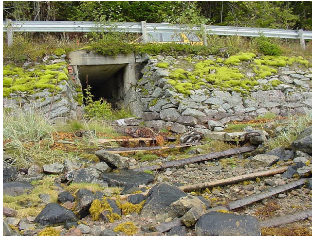
Stikkrenne. Foto: Per Gevik
