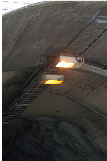
Lysarmaturer i Tunnel. Foto Kjell Wold
