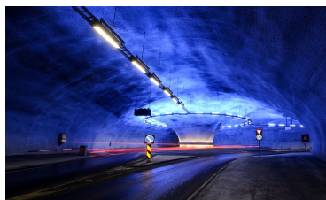
Lyssetting i Vallaviktunnelen. Foto Knut Opeide
