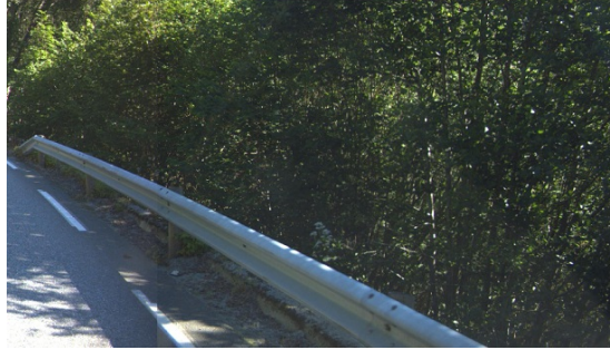
Redusert klippebredde på grunn av busker og trær. Foto: Statens vegvesen.
