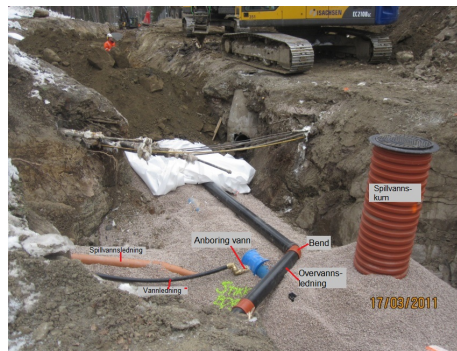
Rørledninger. Foto Terje Rønneberg
