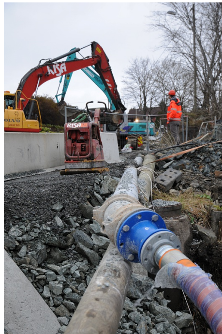
Rørledninger tilhørende veganlegg: Foto: Anja Kristin Bakken
