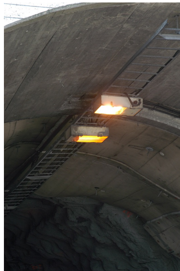
Lysarmaturer i Tunnel. Foto Kjell Wold
