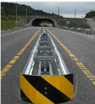
Avslutning i støtpute (Støtpute er eget objekt i Datakatalogen)
