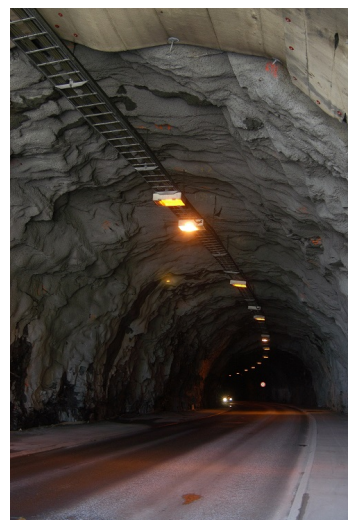
Figur 6: Kabelstige i tunneltak i Flekkerøytunnelen. Foto Kjell
