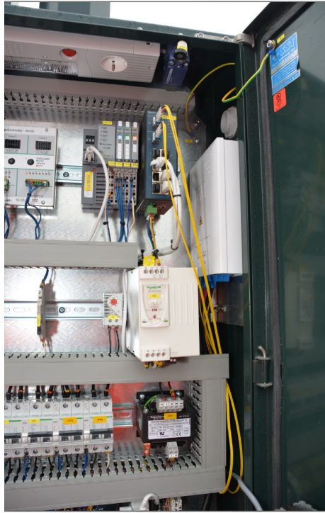
Måler plassert i fordelingskap. Foto: Tore Paulsen
