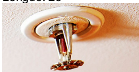
Brannslukking med sprinkleranlegg i tak
