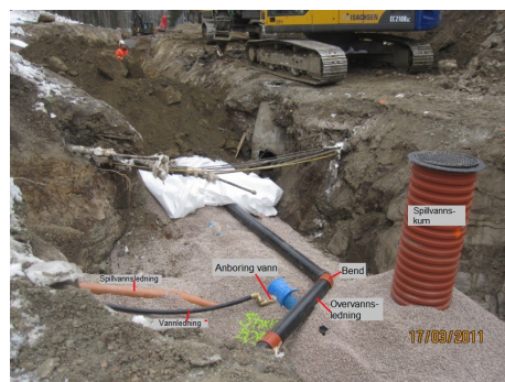
Rørledninger. Foto Terje Rønneberg
