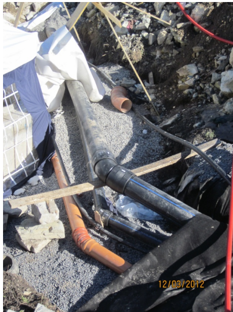
Rørledninger med bend. Foto Terje Rønneberg
