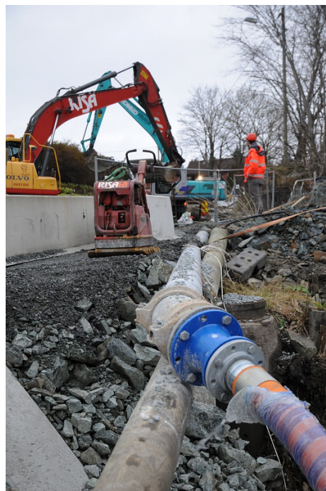
Rørledninger tilhørende veganlegg: Foto: Anja Kristin Bakken
