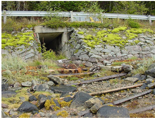
Stikkrenne. Foto: Per Gevik
