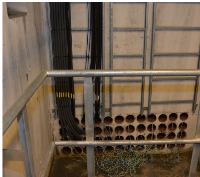
Trekkerør inn til hovedfordeling. Foto: Tore Paulsen
