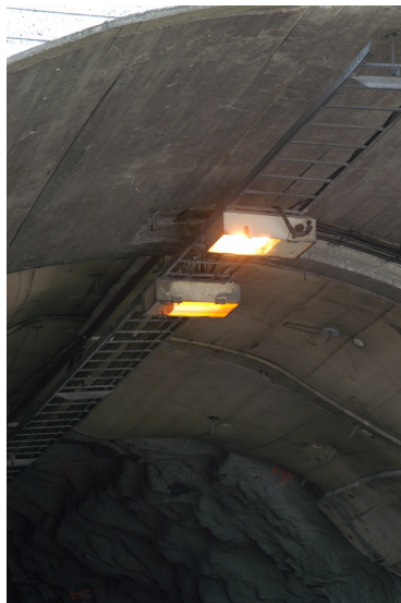
Lysarmaturer i Tunnel. Foto Kjell Wold
