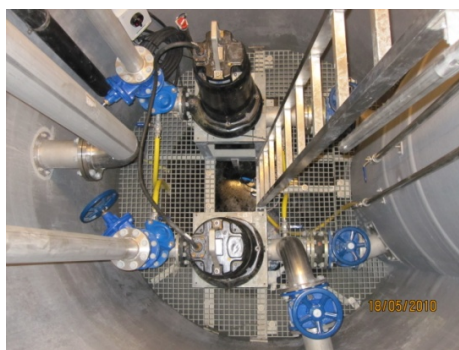
Pumpe-stasjon i kum. Foto: Terje Rønneberg
