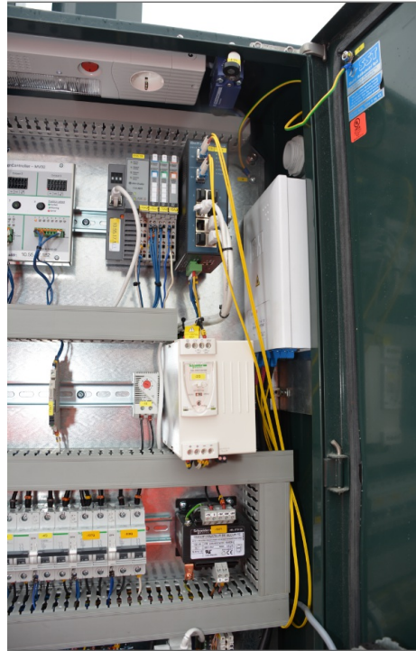
Måler plassert i fordelingskap. Foto: Tore Paulsen
