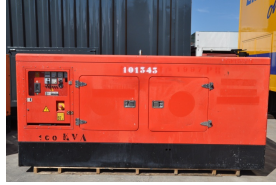
Stasjonært strømaggregat. Foto: Bredenoord
