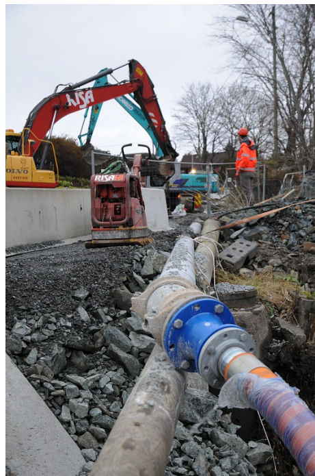
Rørledninger tilhørende veganlegg: Foto: Anja Kristin Bakken
