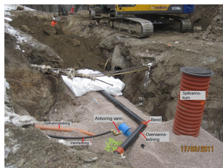
Rørledninger. Foto Terje Rønneberg
