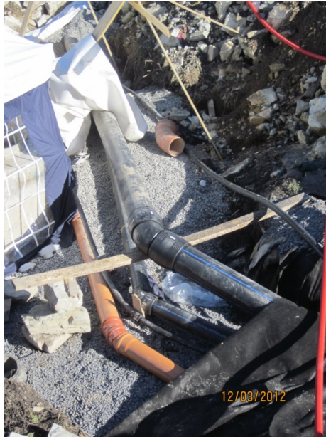
Rørledninger med bend. Foto Terje Rønneberg
