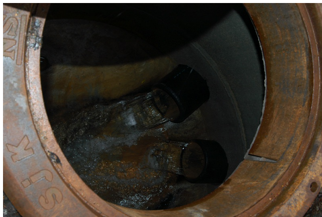
Kum i tunnel. Foto: Kjell Wold
