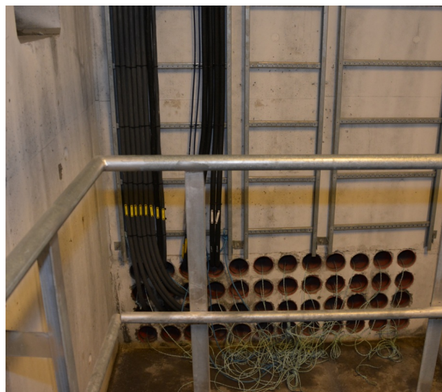
Trekkerør inn til hovedfordeling. Foto: Tore Paulsen
