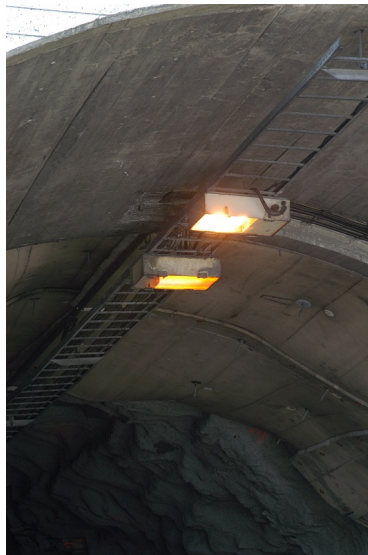
Lysarmaturer i Tunnel. Foto Kjell Wold
