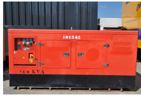
Stasjonært strømaggregat. Foto: Bredenoord
