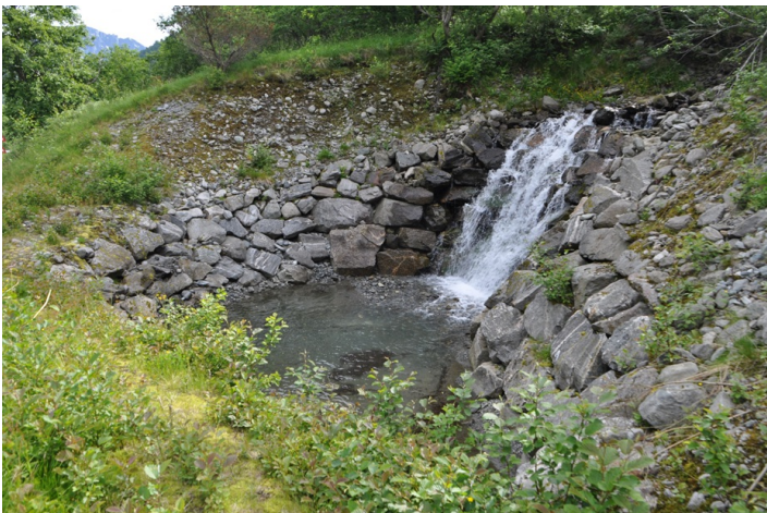
Figur 7: Sikring for sørpeskred/flomskred. Foto: Marie Drågen
