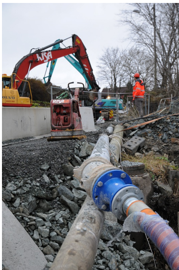
Figur 4: Rørledninger tilhørende veganlegg. Foto: Anja Kristin Bakken
