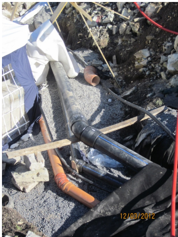
Figur 6: Rørledninger med bend. Foto Terje Rønneberg
