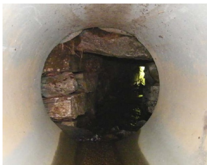
Figur 8: Stikkrenne som er forlenget
