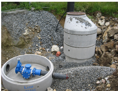
Vannkummer. Foto Terje Rønneberg
