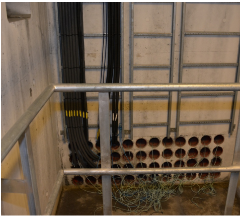
Trekkerør inn til hovedfordeling. Foto: Tore Paulsen
